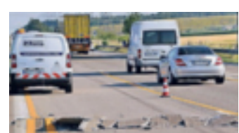
Hier ist die Betonfahrbahn aufgebrochen. FOTO: DPA
